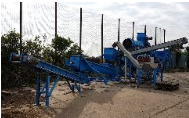
Bodenbehandlungsanlage am Standort Thronitz
